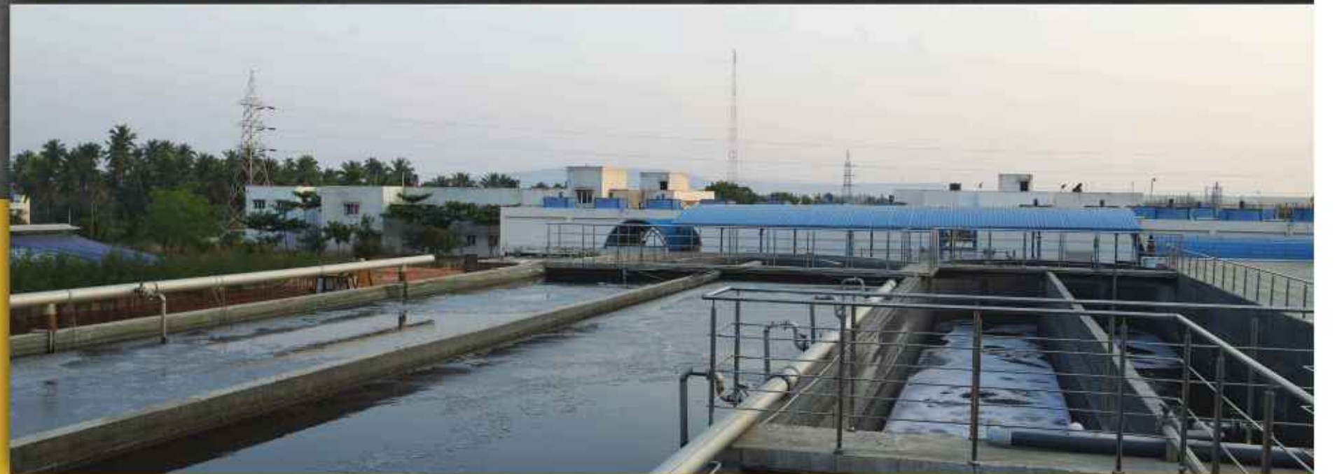
Effluent Treatment Plant, 25 Lakhs litre / Day
